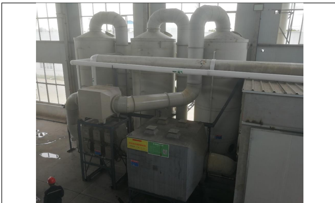
两级碱喷淋+一级水喷淋
