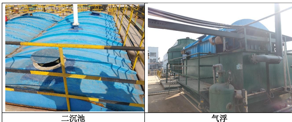
图4.1-2 废水治理设施图片
