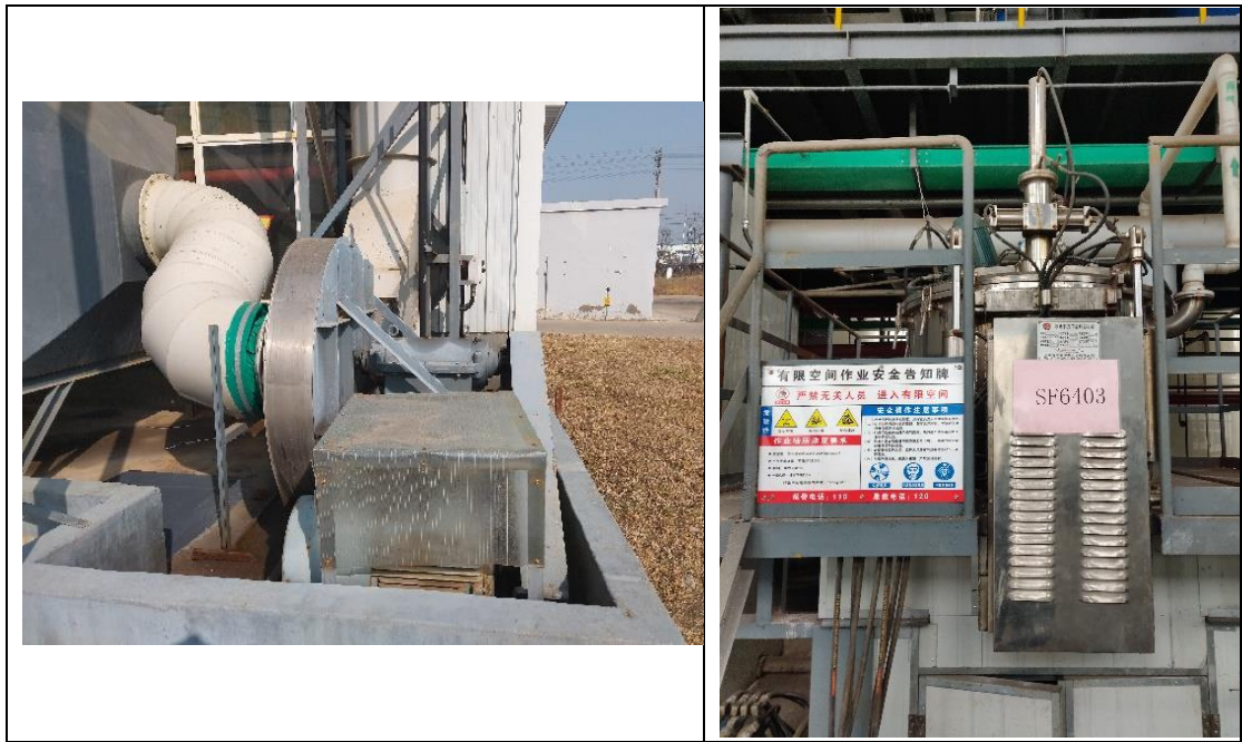
图4.1-6 噪声治理设施图片
